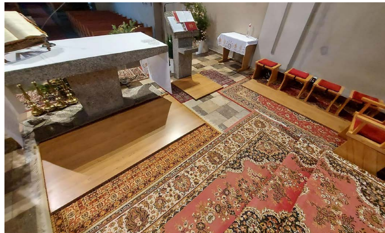
Ogrzewanie prezbiterium w kościele pw. św. Marcina w Lelowie
